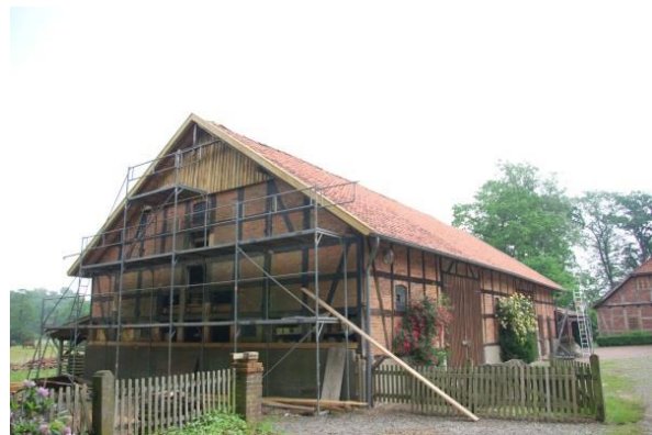
Sanierung der Fachwerkscheune in Groß Häuslingen mit Hilfe von Mitteln der Dorfentwicklung
